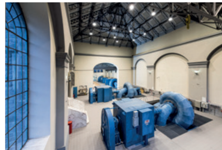
Ansicht des Maschinenraums des Wasserkraftwerks von Töll, dem ersten in Südtirol: es ging schon 1898 in Betrieb.
