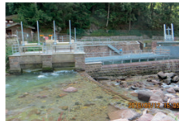
Die Wasserfassung des Kraftwerks Pontives im Grödnertal, vollständig renoviert.
