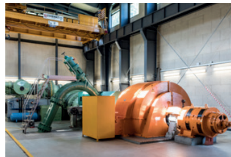
Innenansicht des Wasserkraftwerks in Weißbrunn, einem der fünf Kraftwerke des Wasserkraftsystems im Ultental.
