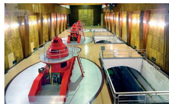
La sala macchine in caverna della centrale idroelettrica di Barbiano.
