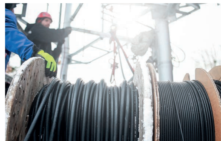
Gestiamo una rete elettrica in bassa, media e alta tensione di circa 8.778 km e ci impegnamo costantemente per garantire una fornitura energetica sicura ed efficiente.
