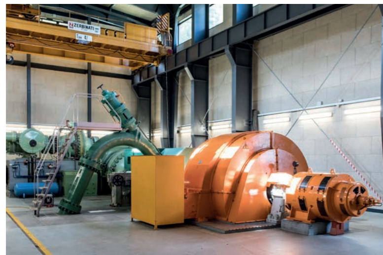
L'interno della centrale idroelettrica di Fontana Bianca, una delle cinque centrali del Sistema idroelettrico della Val d'Ultimo.
