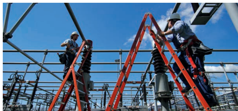
Gestiamo una rete elettrica in bassa, media e alta tensione di circa 8.630 km e ci impegnamo costantemente per garantire una fornitura energetica sicura ed efficiente.
