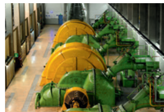
L'interno della centrale idroelettrica di Lana, una delle cinque centrali del sistema idroelettrico della Val d'Ultimo.
