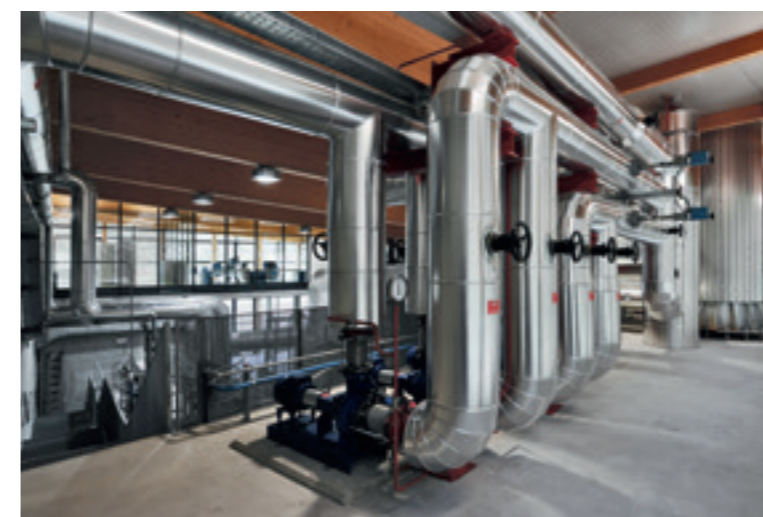
L'interno della centrale di teleriscaldamento di Chiusa, una delle sei centrali in Alto Adige del Gruppo Alperia.
