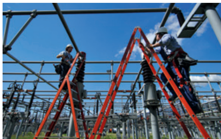
Gestiamo una rete elettrica in bassa, media e alta tensione di circa 8.630 km e ci impegnamo costantemente per garantire una fornitura energetica sicura ed efficiente.
