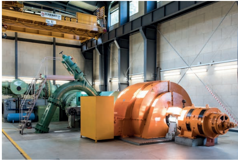
Innenansicht des Wasserkraftwerks in Weißbrunn, einem der fünf Kraftwerke des Wasserkraftsystems im Ultental.
