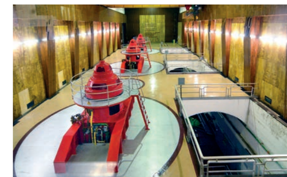
Der Maschinenraum im Wasserkraftwerk Barbican.
