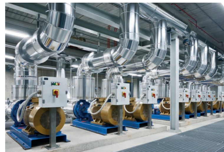
Der Maschinenraum des Fernheizwerks Bozen, eines von sechs Anlagen der Alperia in Südtirol
