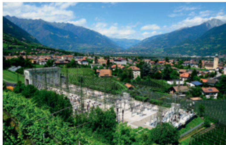
Das Wasserkraftwerk Lana
